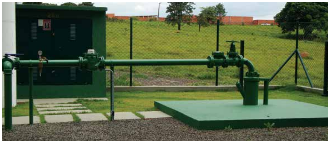
Figura P1-2. Poço tubular (Foto por: Antonio Pinhatti)
