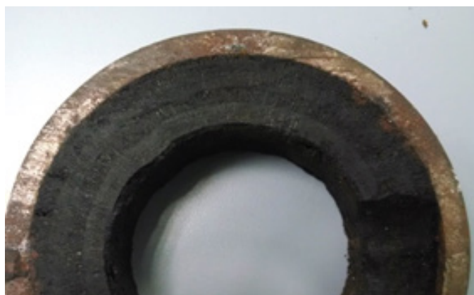
Ejemplo de incrustación carbonatos.
