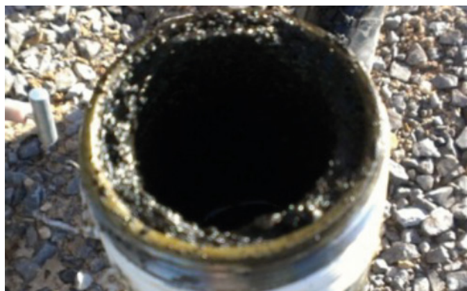
Ejemplo de incrustación asfáltenos.
