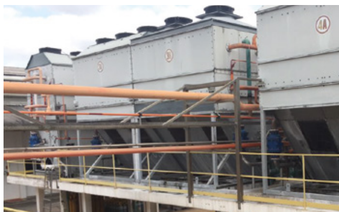
CERPA CD08 Condensador Evaporativo 4
