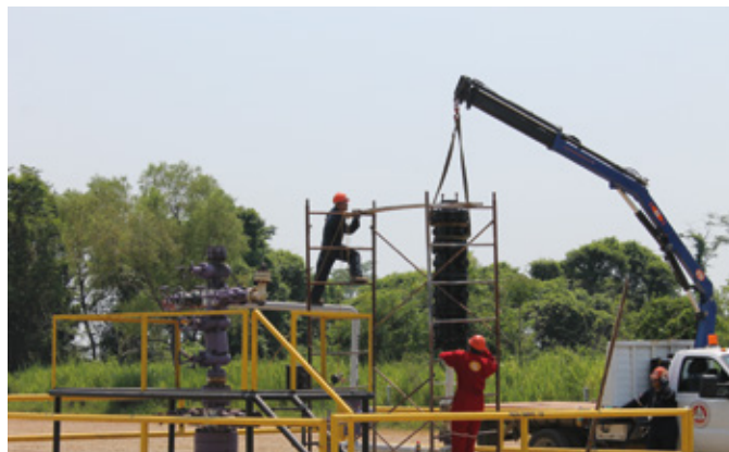
Instalación catalizador Solavite Oil&Gas Agave 52, México
