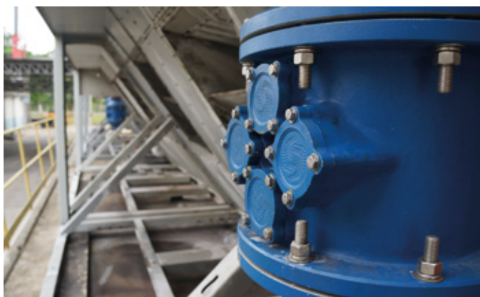
CERPA CD08 Condensador Evaporativo 6
