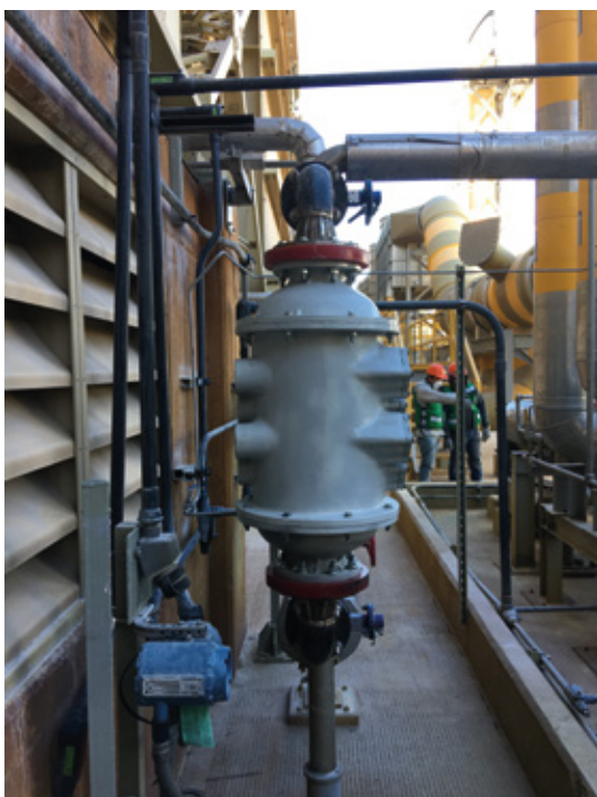
Instalación catalizador Solavite Hydro
