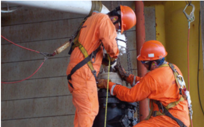
Instalación catalizador Solavite Oil&Gas plataforma petrolera
