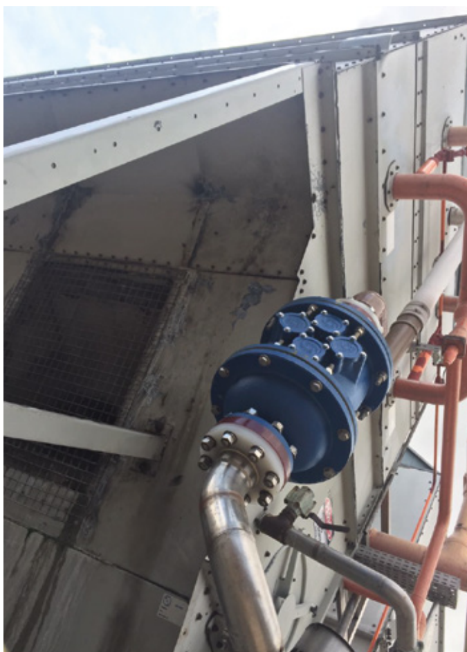
CERPA CD08 Condensador Evaporativo 1
