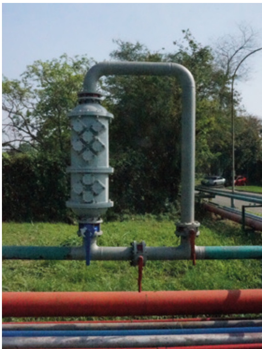
■ Bayer CD-20 Red de suministro de agua 1
