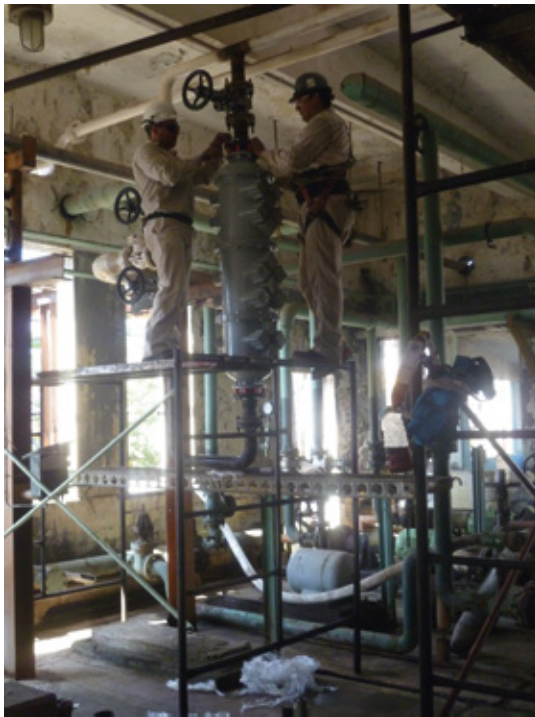
Instalación catalizador Solavite Hydro
