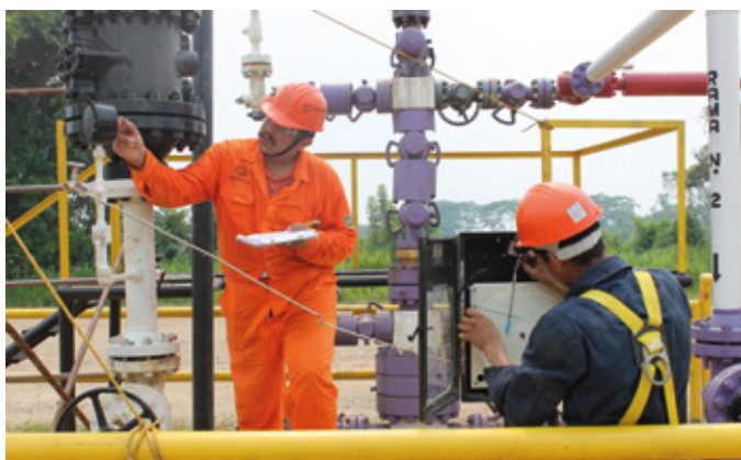
Medición de flujo del pozo petrolero
