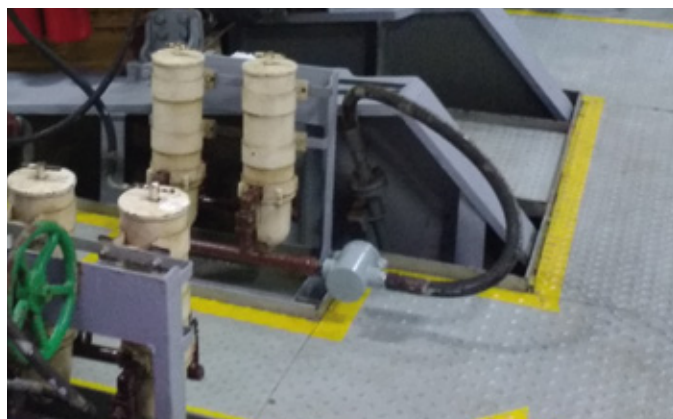
Solavite Motor R-03 en la alimentación de diesel
