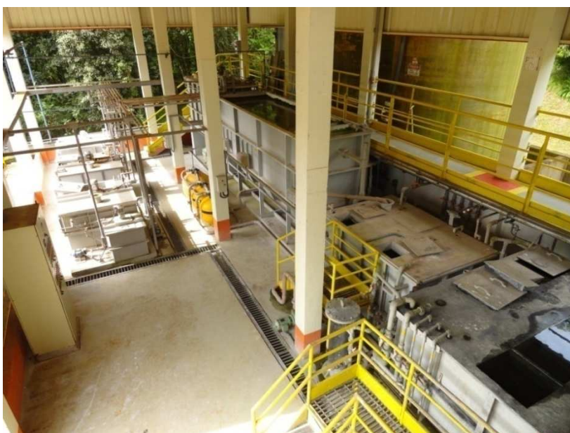
Figura 22 - Vista interna ETE tratamento físico-químico
