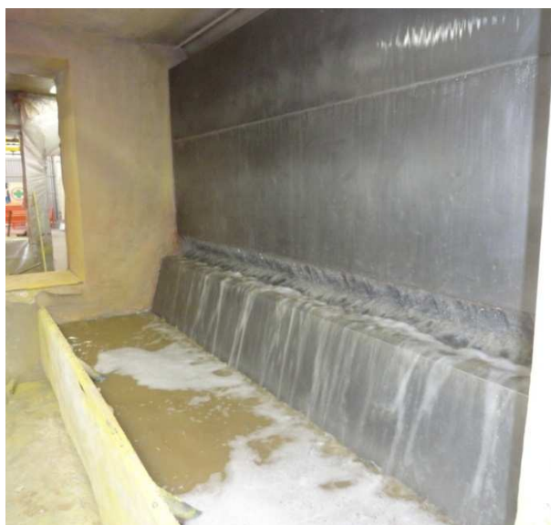
Figura 8 - Cabine de pintura com cortina d'água
