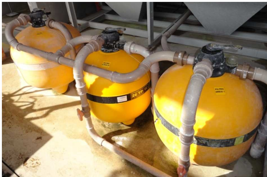
Figura 21 - Sistema de filtros
