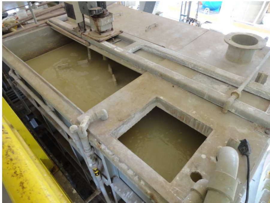
Figura 19 - Tanque de coagulação/floculação
