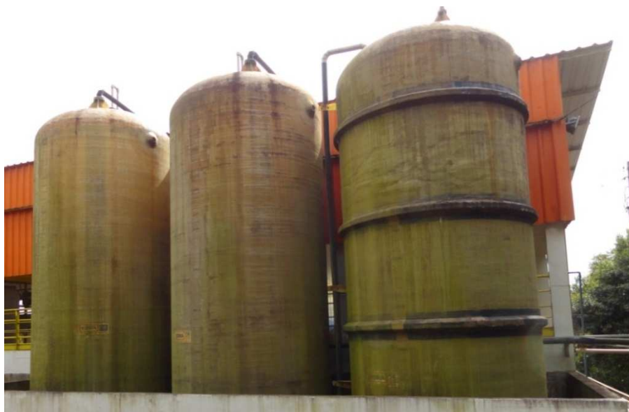
Figura 14 - Tanques de acúmulo do efluente industrial
