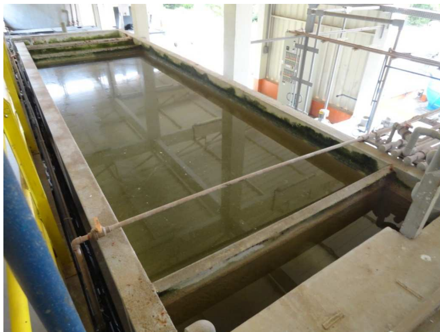
Figura 20 - Tanque de decantação
