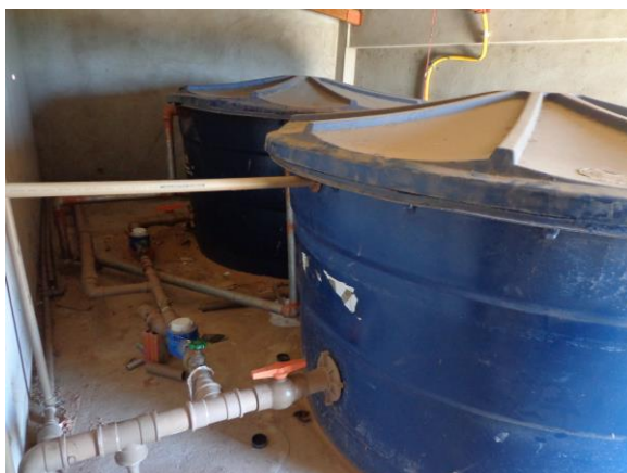
Figura 14 - Sistema de reservação superior de água potável e pluvial da FE
